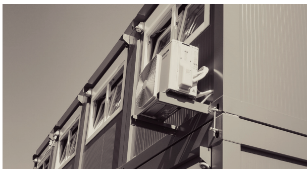
Climatisation et pompe à chaleur
